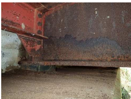
図 1.3 鋼橋の損傷状況
