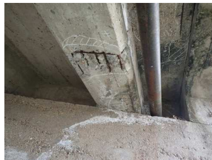
図 1.4 コンクリート橋の損傷
